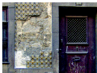
08 | Degradação de argamassas
