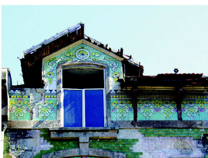
09 | Abandono e negligência
